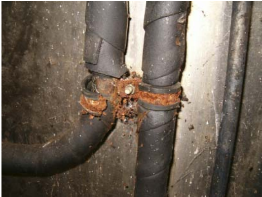
Figur 6.9. Eksempel på tæring i inventar-/bygningssdele, som kan betyde, at de pågældende dele ikke længere er ordentlig forbundet til elektrisk neutral jord.
