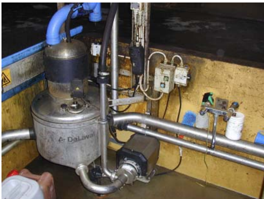
Figur 6.11. Ledningen (supplerende udligninger) fra vandhanen ikke forbundet til rørene fra mælketanken.
